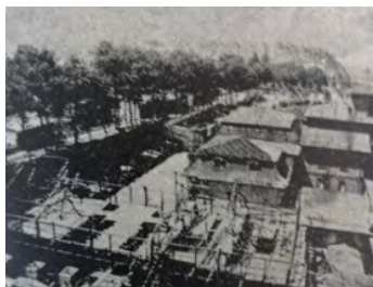
Figura #11. Vista general del proceso de construcción de la zona de fermentación en 1926, actual Teatro de la Danza.
